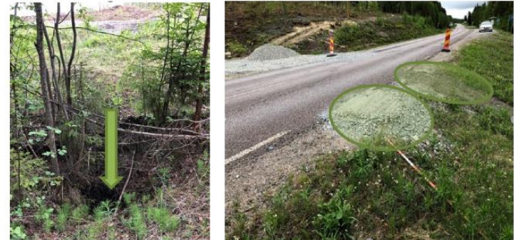
Figur 54. Bildning av hål i nedre vägslänt samt lagning av uppkomna hål. Foton: Erik Eriksson, Trafikverket
