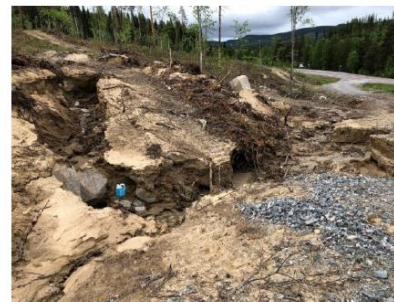
Figur 53. Erosion i skogsbilväg. Notera dunk med spolarvätska. Foto: Erik Eriksson, Trafikverket
